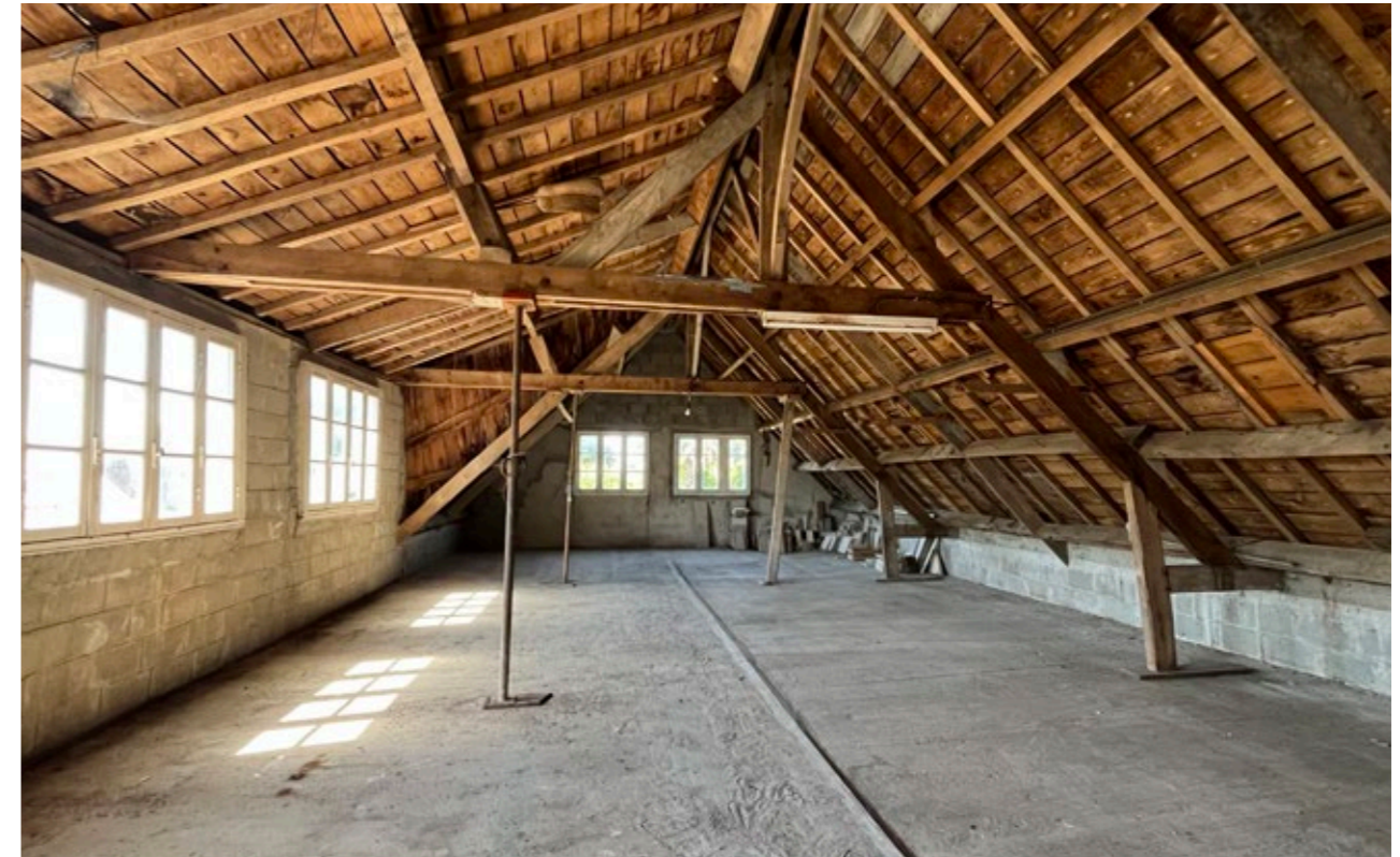
Vue intérieure du bâtiment à l'étage, la charpente en bois, n'est pas en bon état et manque de pièces constructives, des étais ont été ajoutés pour soutenir la charpente.
