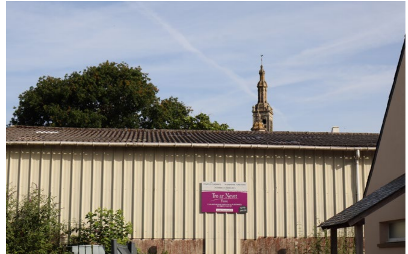
Les façades de la partie atelier sont en bardage métallique beige. On aperçoit l'église derrière.
