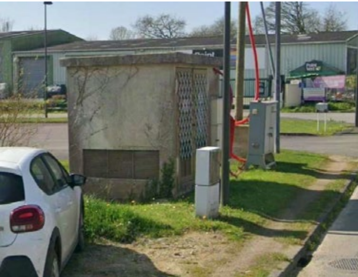
Poste de transformation
