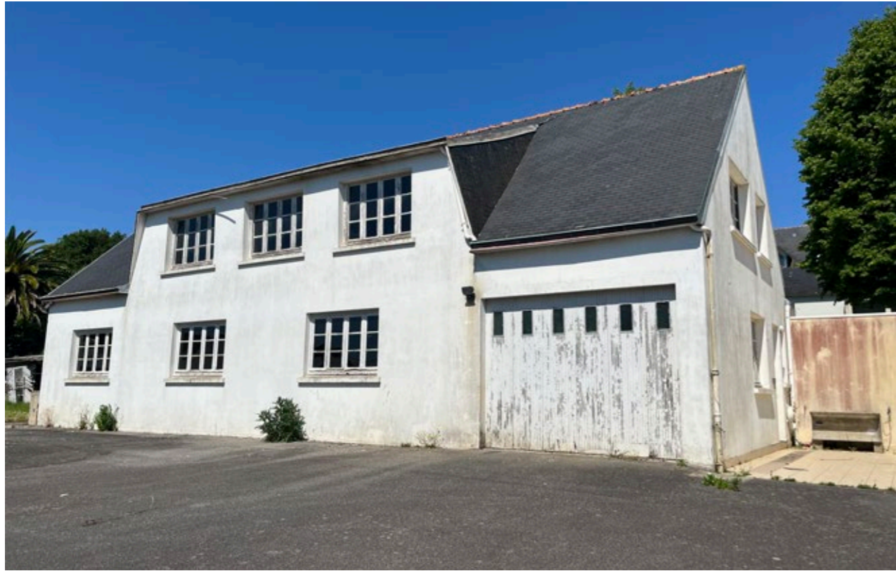
Vue de l'atelier sur cour au sud, le bâtiment est en mauvais état. La toiture est à double-pente en ardoise, avec une lucarne rampante. Les menuiseries sont en bois.
