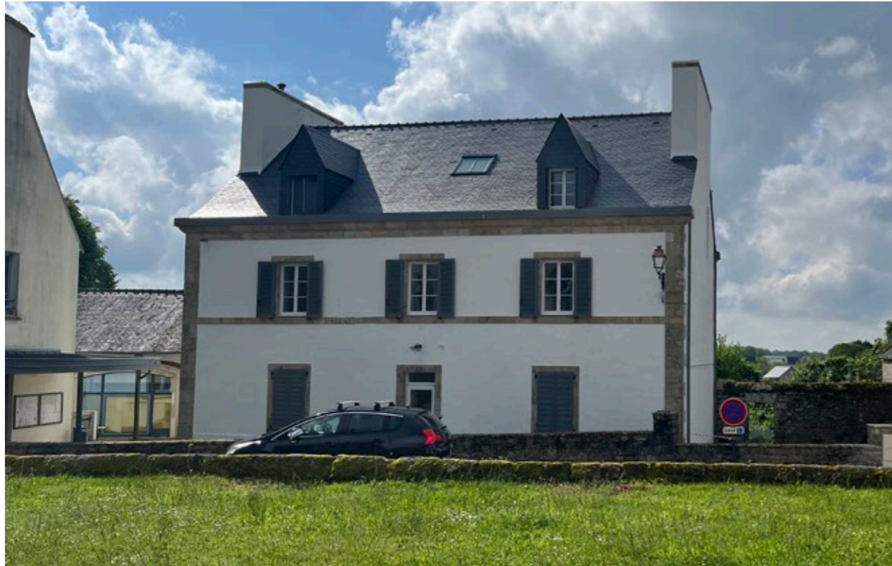
Vue de la façade sur rue du Presbytère au Nord : la façade à été rénovée avec changements des menuiseries et volets, rénovation et remise en enduit, toiture refaite, rénovations des encadrements granit.
