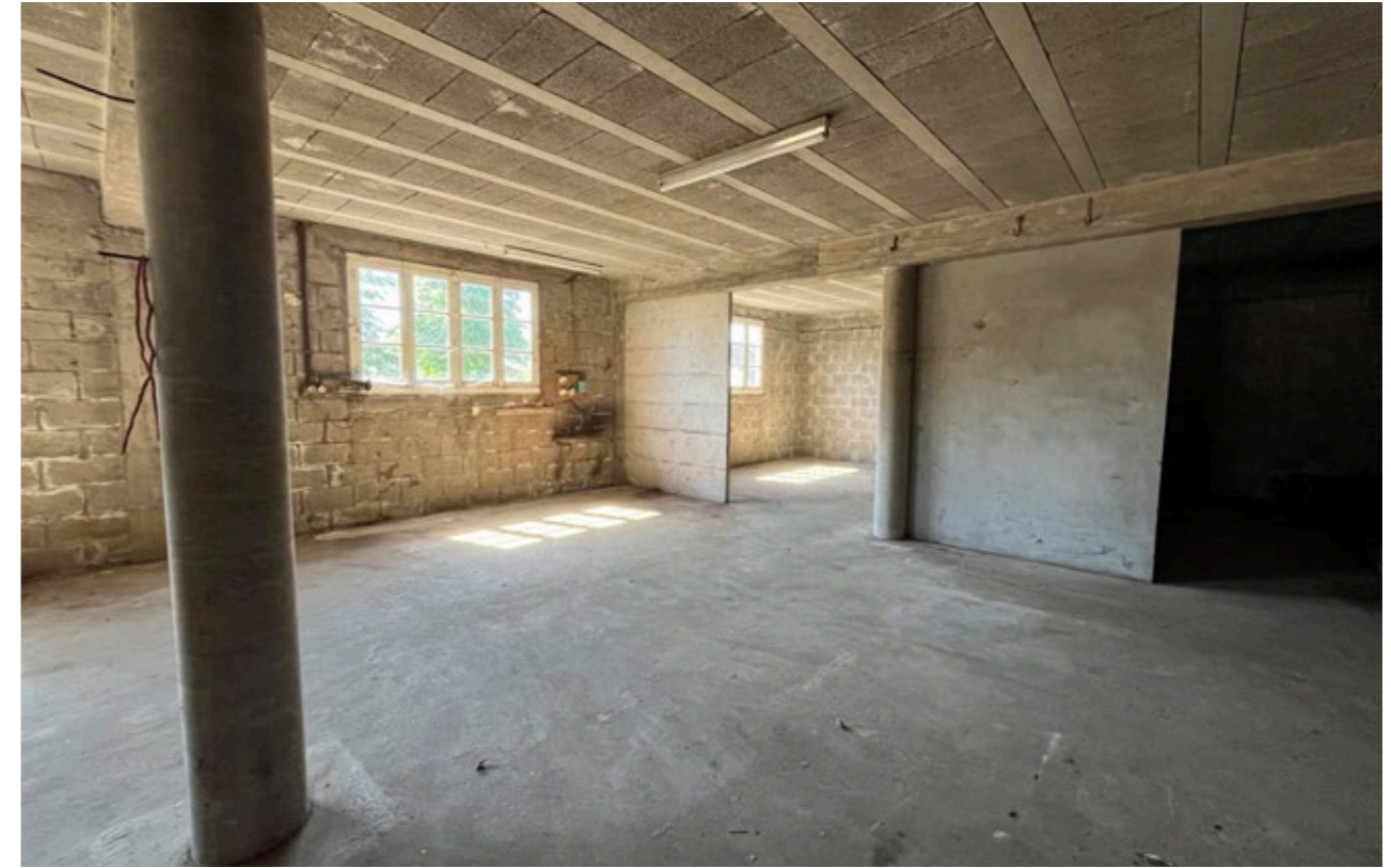
Vue intérieure du bâtiment à RDC, les murs sont en parpaings, les poteaux et la dalle en béton.
