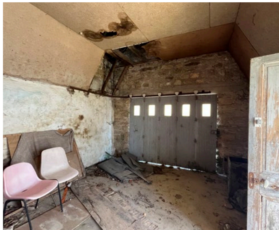
Vue intérieure de la pièce « garage » côté rue, il y a des doublages en medium et de fortes traces d'humidité, il y a une infiltration par la toiture.
